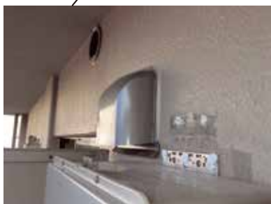
排気側 外部の排気口です。
