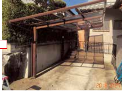
工事前 屋根のパネルが 飛んでしまいま した
