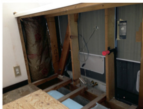
手洗い器排水管
