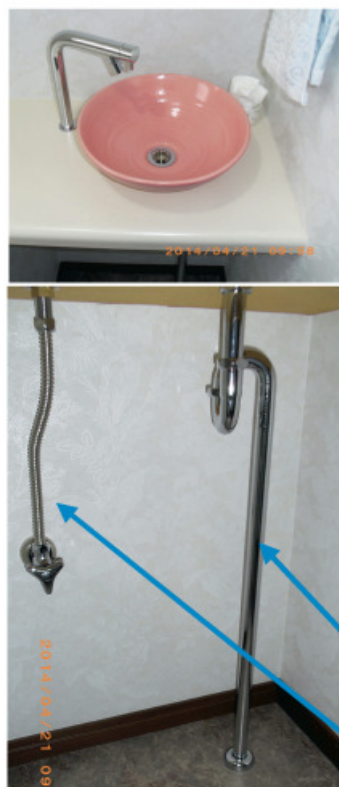
手洗い器水排水管
