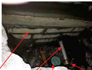
浴槽からの 排水管
