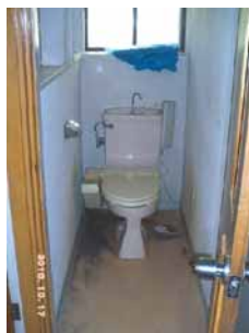
①既存トイレ 床がギシギシ
