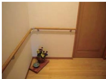
↑壁に直接取付 壁下地はコンパネです
